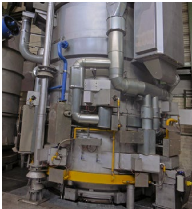
Eine der Heizhauben der Haubenglühanlage mit den neu installierten außenliegenden extragroßen Rekuperatoren.
